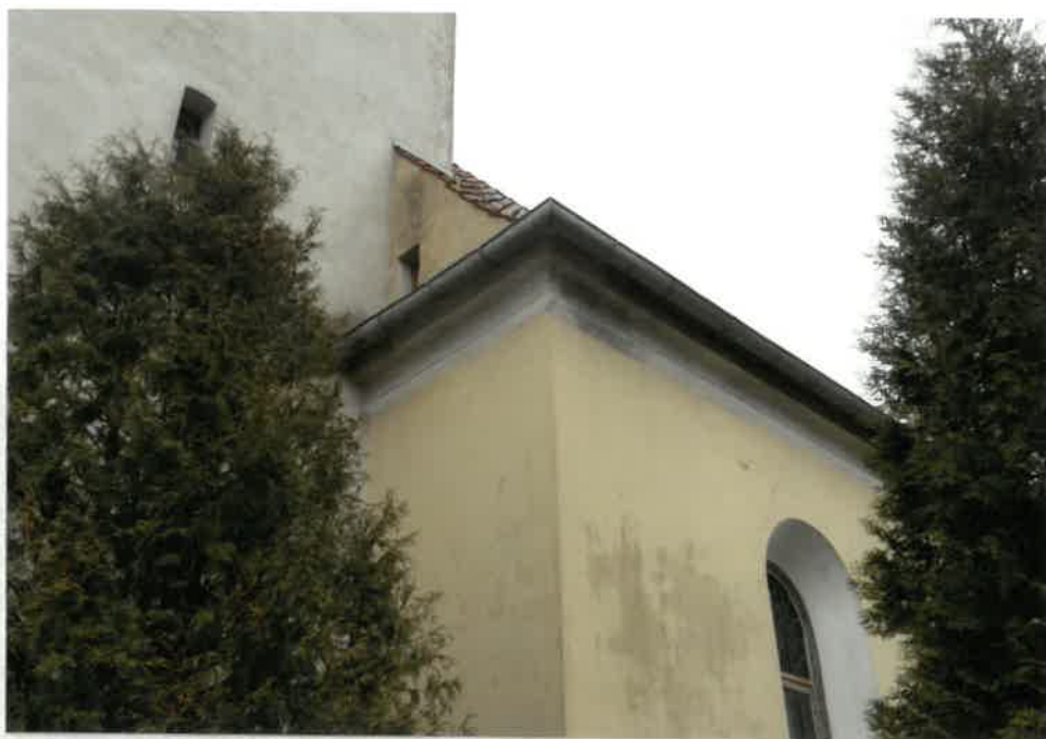
Fragment z widocznymi plamami na elewacji.
