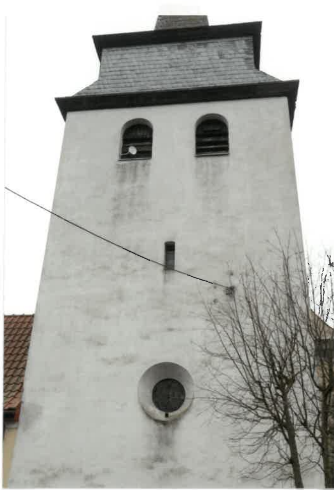
Wieża, widok zabrudzeń smółkowatych.
