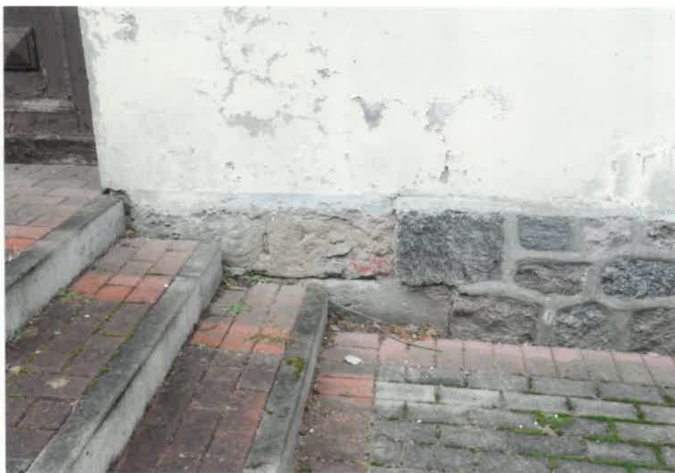
Fragment z widocznym ubytkiem kamiennego cokołu
