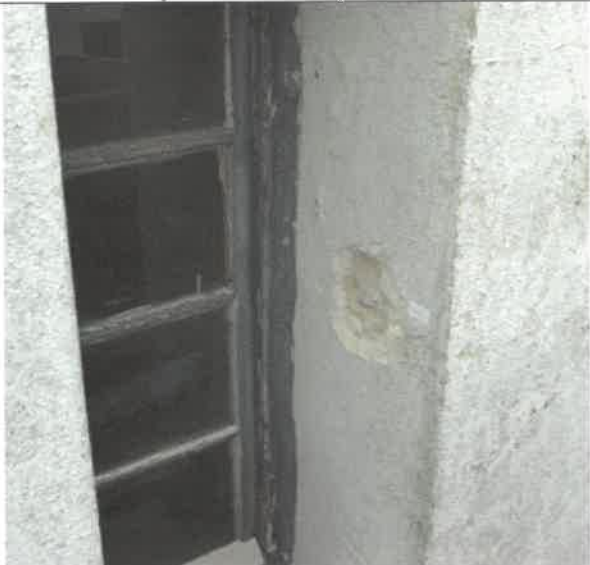
Odkrywka św/e3- tynk w ościeżu okna
