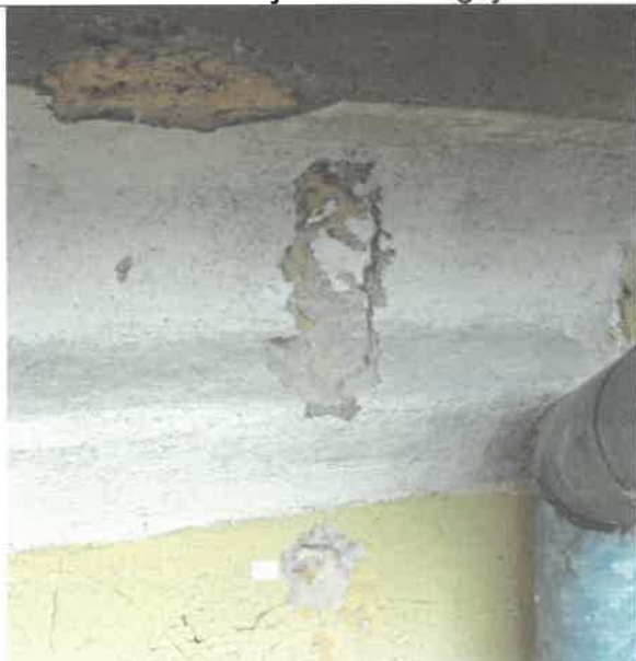
Odkrywka św/e5- gzyms
