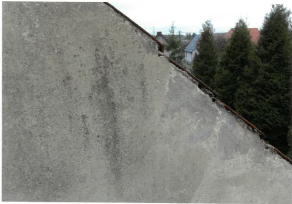
Zbliżenie elewacji z widocznymi złuszczeniami farb i nawarstwieniami brudu
