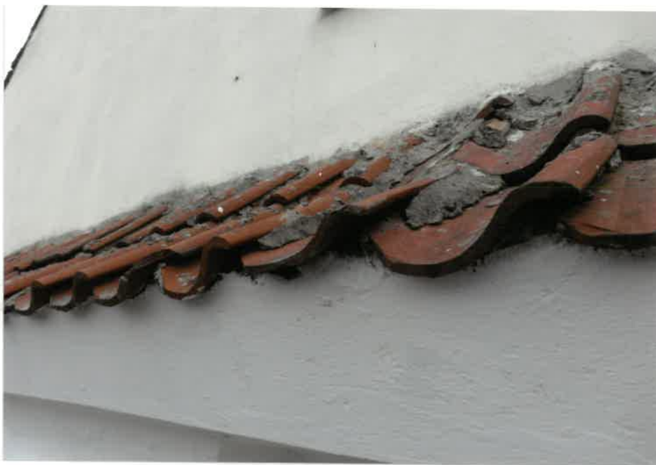
Wtórny nieestetycznie wykonany daszek na gzymsie
