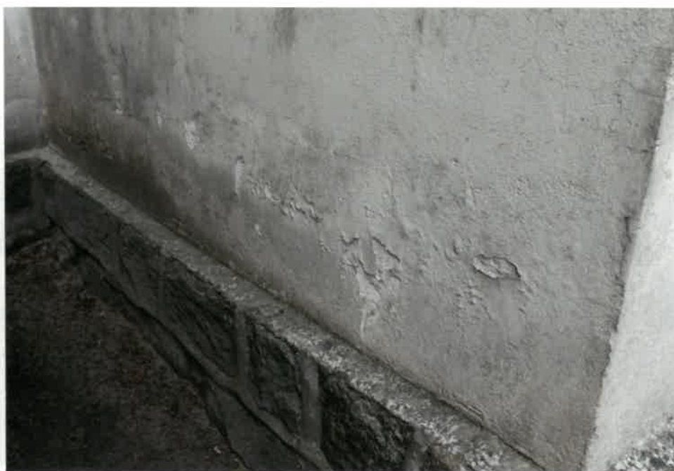
Zbliżenie fragmentu elewacji ze strefą zawilgoconą- wykwit i złuszczenia.
